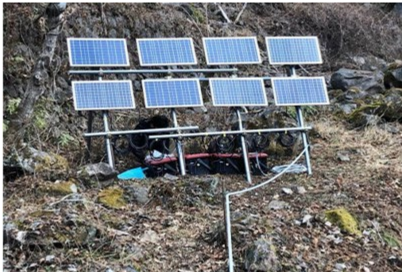
ソーラーパネル設置状況設置状況
