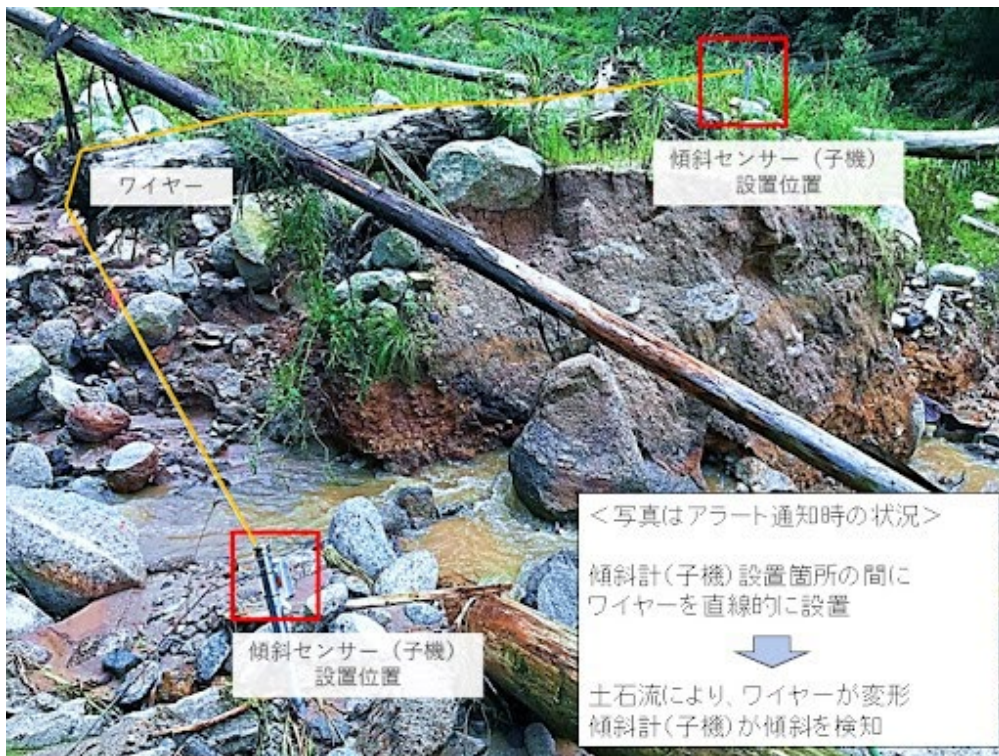
土石流検知時の現場状況
