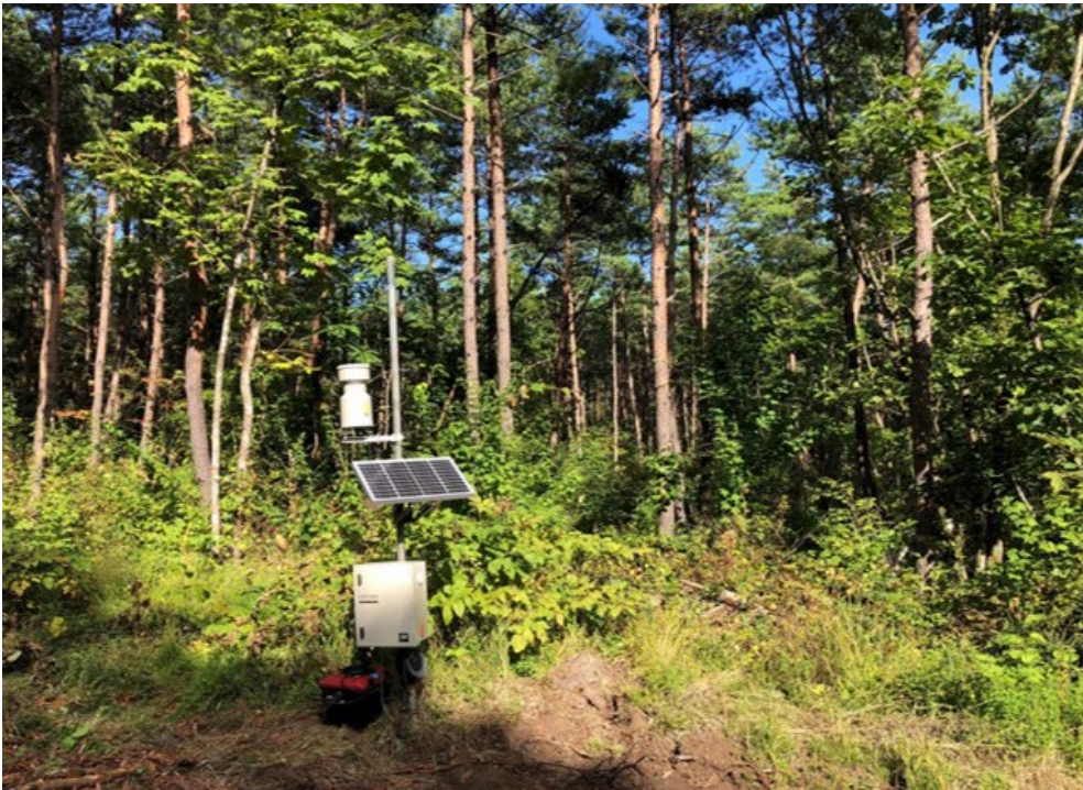
雨量計測機器との接続状況
