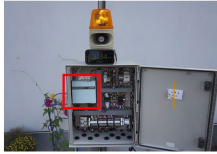
図2 データ収集制御ボックス及びパトランプ ※赤枠部分がクラウドロガーLTE
